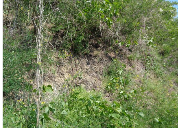
위 치 STA.2+340~430 3단 내 용 와이어로프 녹발생 및 능형망 노출
